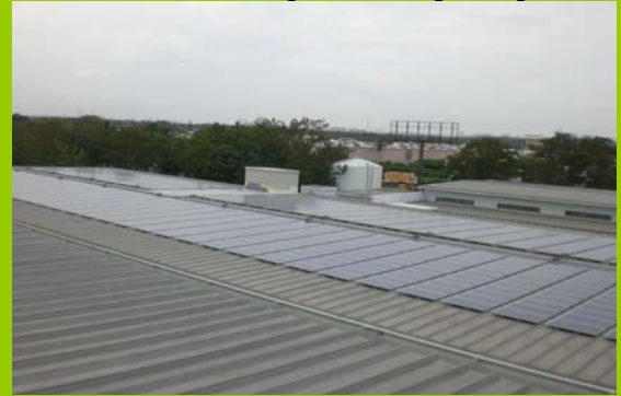
Paneles solares sobre techo de Mini Warehouse de Carolina
